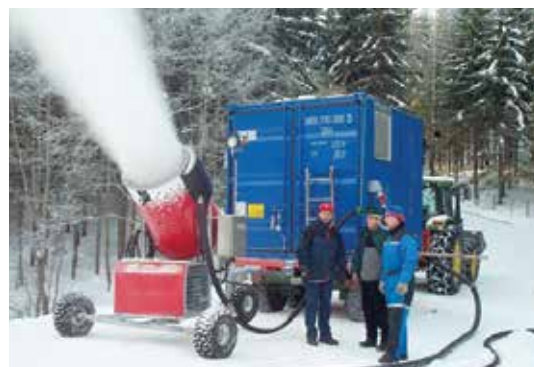
Flyttbare system med kanoner og aggregat er mest anvendt i mindre anlegg og langrennsanlegg.
