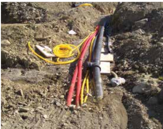
Rørgate, strømkabel og luftledning graves ned i en ordentlig grøft for lang levetid og reduserte synlige hindringer i bakken.
