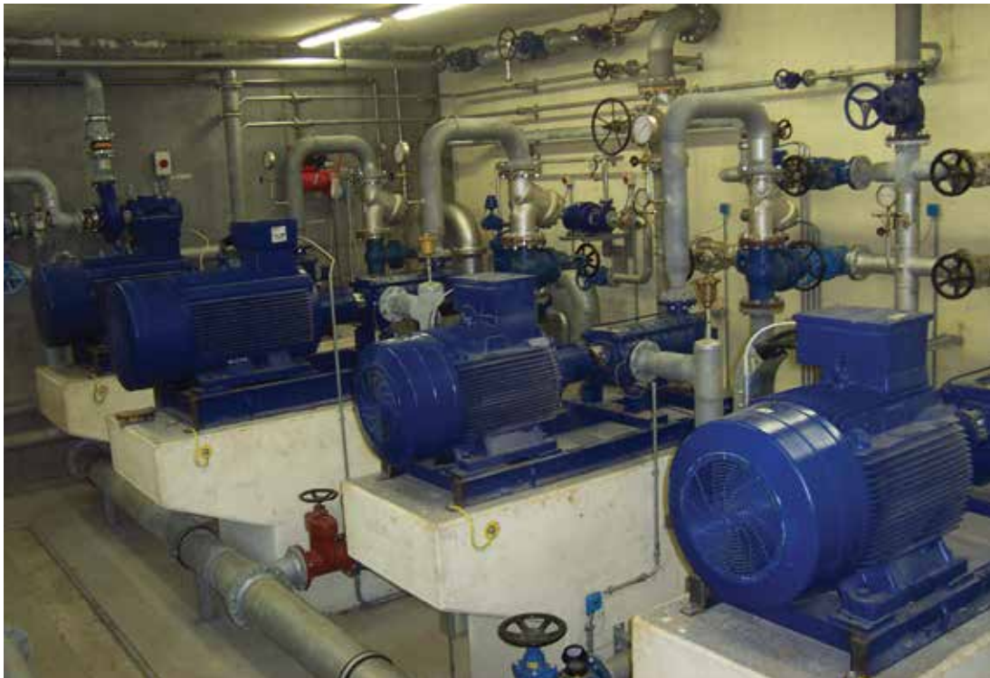
Stort pumpehus for trykkøkning av vann til snøproduksjon ut i nedfartene.
